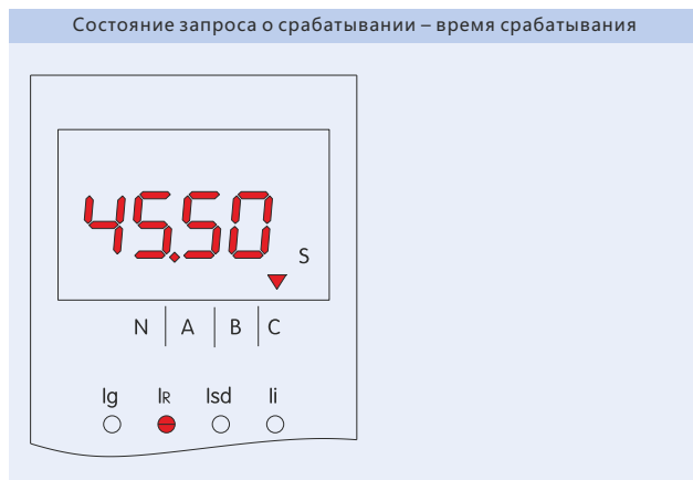
Состояние запроса о срабатывании – время срабатывания
